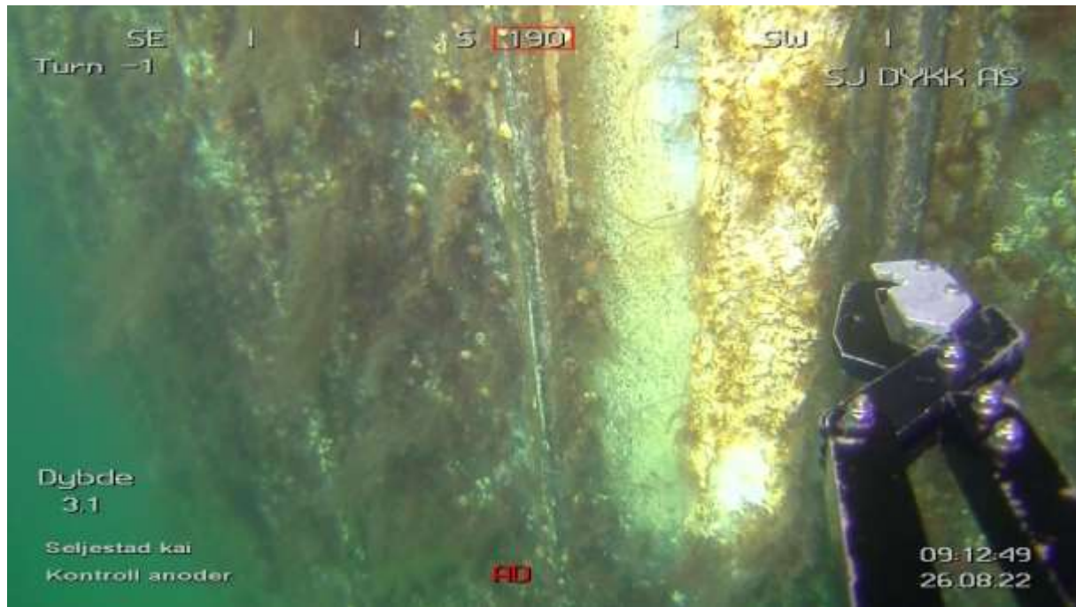
Figur 3 Celle 5,5: Løs sveis på anode (5,5c) i underkant
