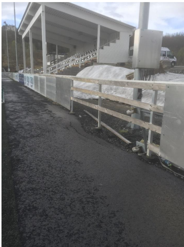
Asfalt og gjerde må utbedres.
