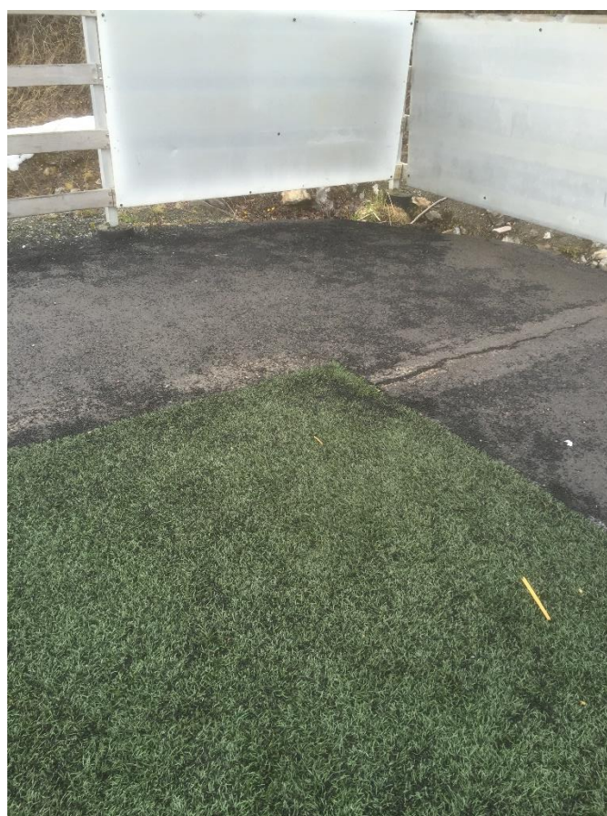
Skader i asfalt over samledrenering.
