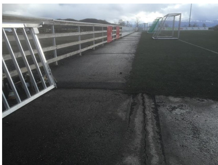
Mer skader ved drensledninger.
