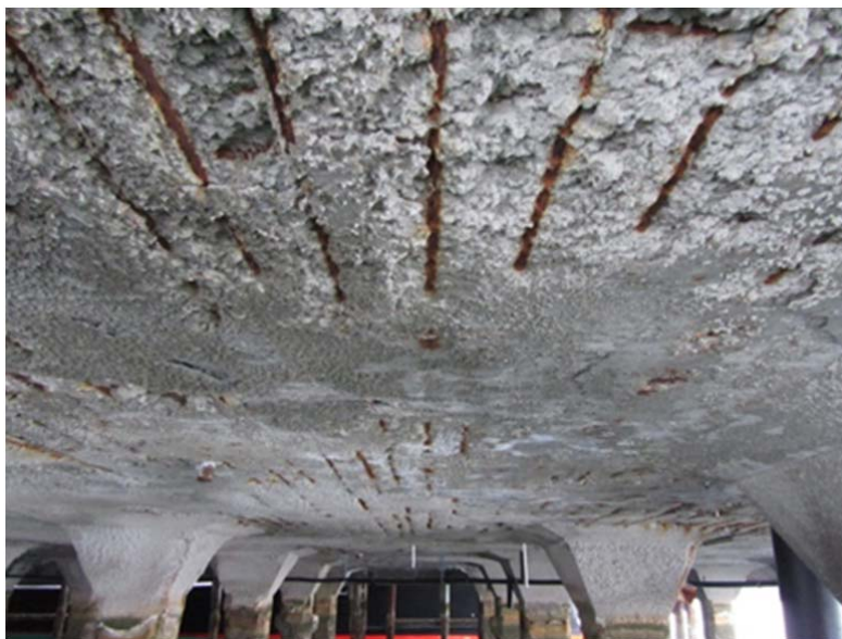
Bilde 8.1, Korrosjonsskader under kai 1 del 3 og kai 2
